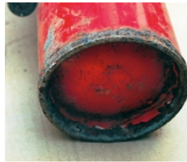
(溶接部とその周辺の腐食)
