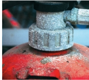
(あばた状の腐食)
